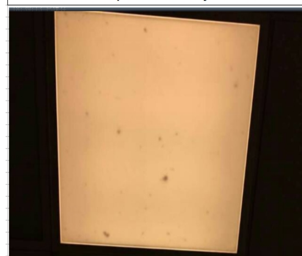
Nieszczelna obudowa - insekty, które przedostały się do wnętrza oprawy powodują charakterystyczne zacienienia.
